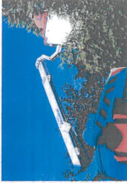
Deux techniciens viennent d'installer des boîtiers de raccordement de la fibre près des maisons situées au lieu-dit la Rougeoillère.
