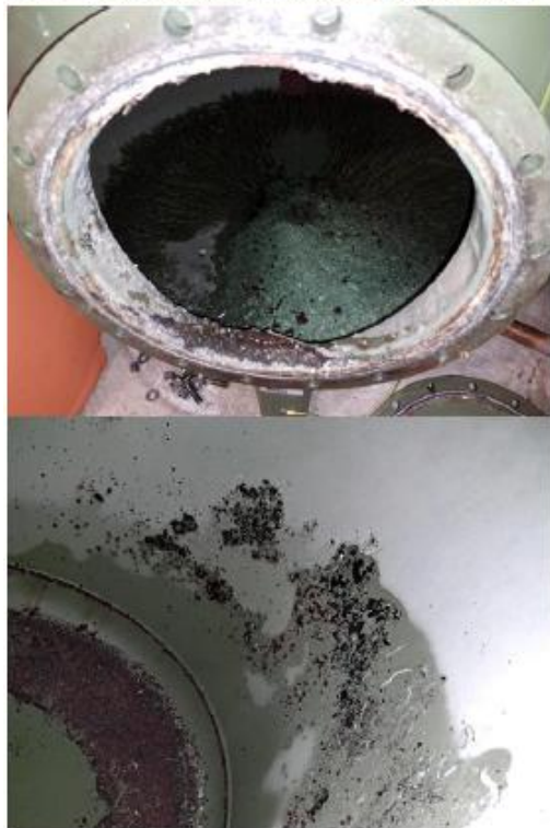
Ballon ECS : corrosion importante des ballons
