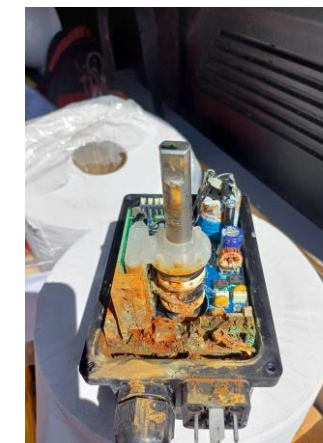
Vanne motorisé de remplissage bâche jeux d'eau
