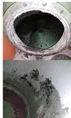
Ballon ECS : corrosion importante des ballons
